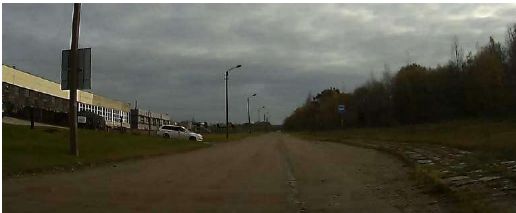
12.3 pav. Susisiekimo infrastruktūros būklė tarp Aukštaičių g. ir pietrytinio Utenos aplinkkelio
