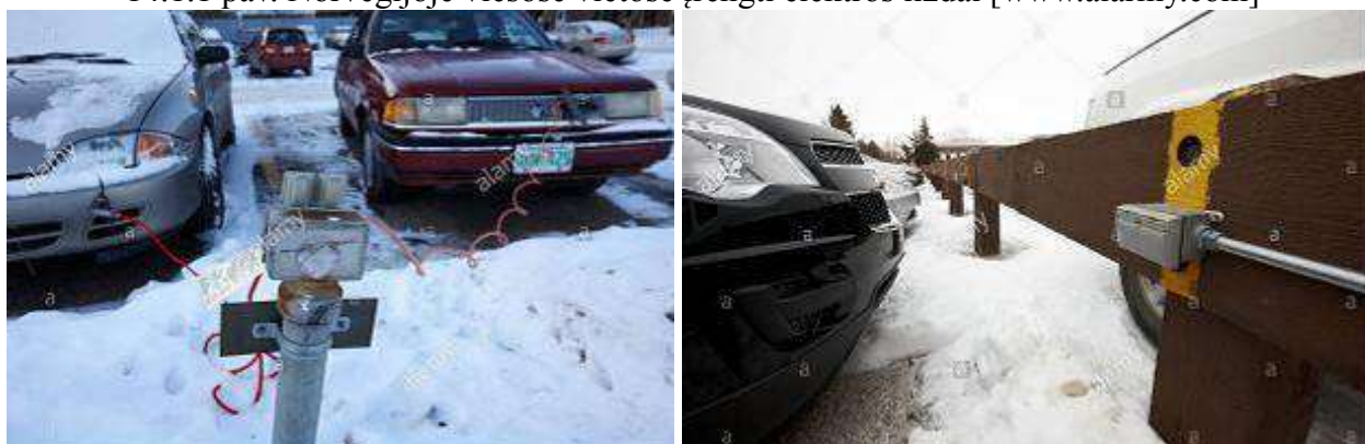
14.1.2 pav. Kanadoje viešose vietose įrengti elektros lizdai [www.alarmy.com]
