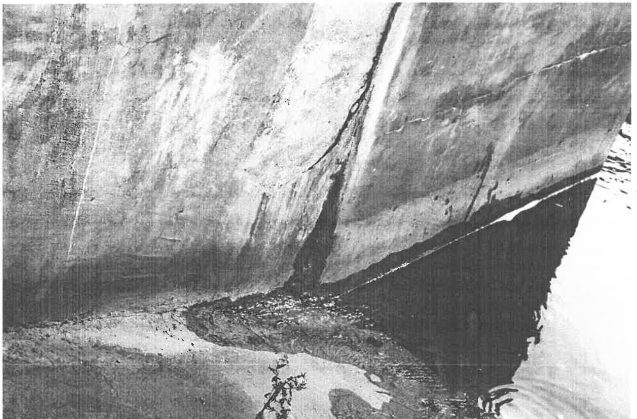
Per risbermos sienų deformacinės siūlės plyšį prasisunkia filtracinis, drenažu nesugaudytas, vanduo. Remontinis betono sluoksnis nutrupėjęs, neatlaikęs garantinio laikotarpio.
