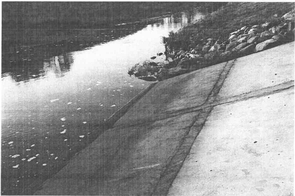
Per tvirtinimo plokščių apatinę dalį prasisunkia geležingas gruntinis vanduo, nudažydamas ruda spalva plokščių paviršius.
