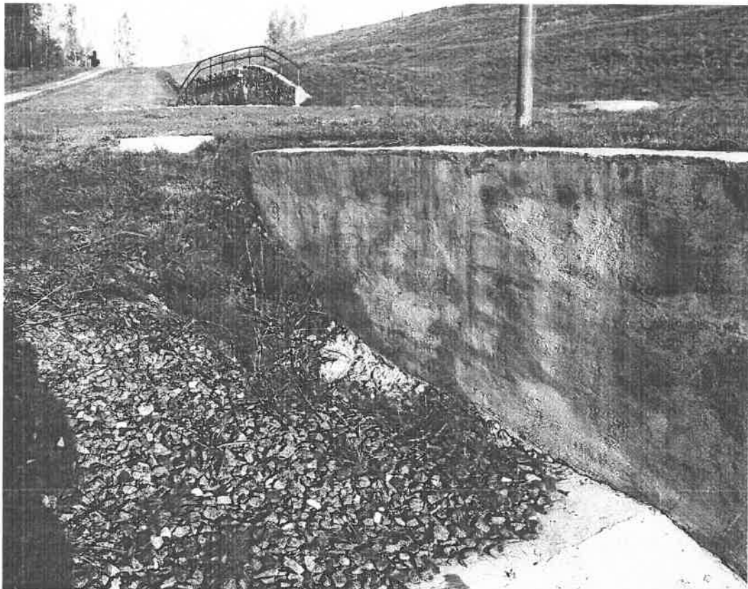
Dešiniajame krante ties risbermos sienute paviršinis vanduo ardo šlaitą.
